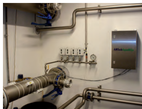
Ultralydsanlægget består i al sin enkelthed af 4 klodser, der er monteret på vandværkets afgangsledning og den rustfrie stålkasse på væggen, der indeholder strømforsyning og styringsenhed til anlægget.
