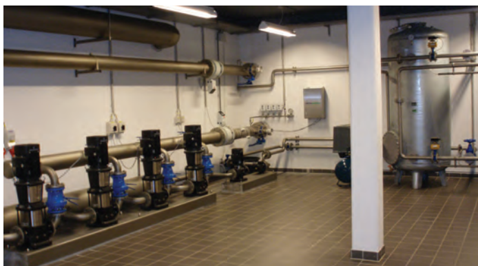
Til venstre i billedet ses rentvandspumperne og bagest er ultralydsanlægget. Under ultralydsanlægget er der en mindre pumpe, som suger fra skyllevandsbassinet og pumper skyllevandet gennem 2 sandfiltre, hvoraf kun det ene er med på billedet. Det filtrerede skyllevand ledes til Kongeåen, og for at få lov til det, stillede amtet krav om, at det skulle filtreres, så det er stort set er fri for jern.
